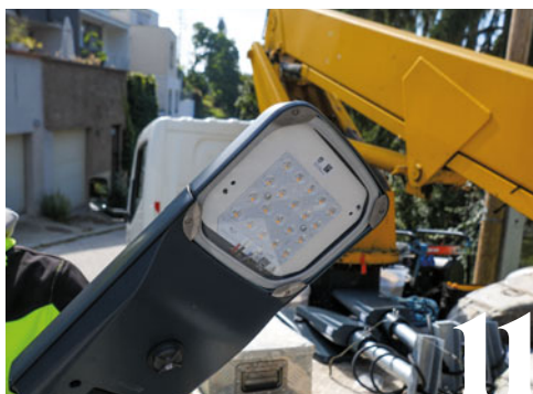
Mesto komplexne modernizuje verejné osvetlenie
